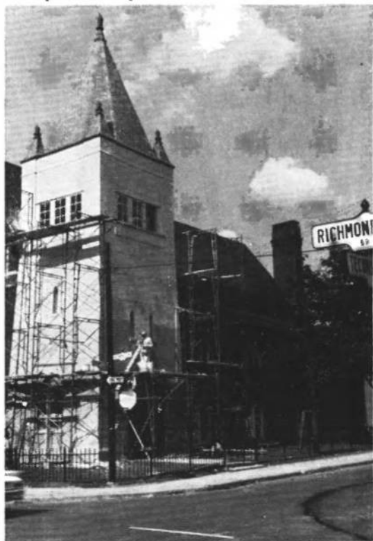
Вигляд церковного будинку в 1959 р. під час штукатурної роботи назовні. На підвищенні працює бр. Є. Переймибіда.
