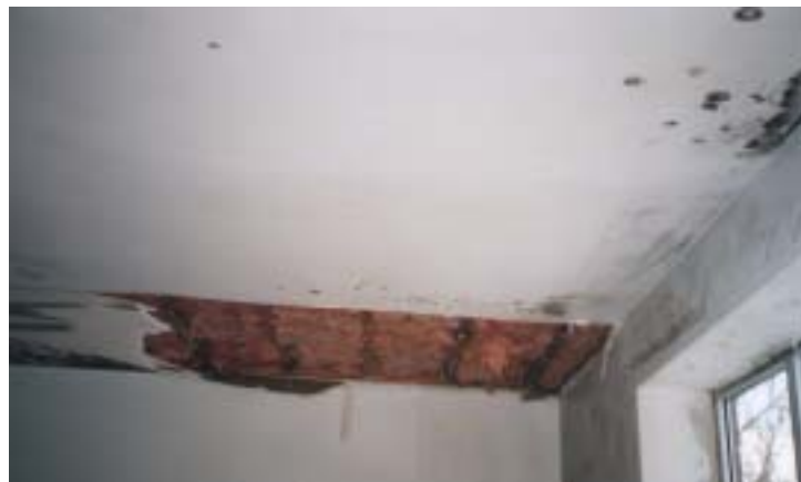
Пошкодження стелі в Святині на 2-му поверсі
